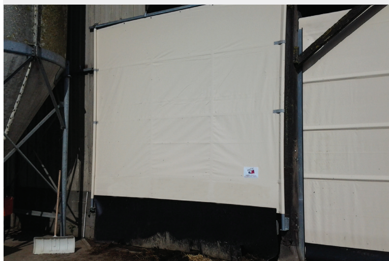
MONTBÉLIARD : Adapté aux couloirs de raclage. Bavette PE en partie basse pour contact avec le racleur. La bavette permet d'obstruer en partie basse les courants d'air.
